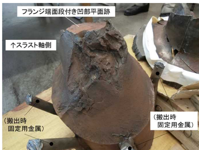
図7 中間軸折損部 (軸側)
