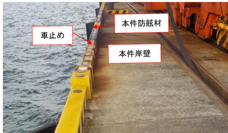
写真2 本件岸壁及び本件防舷材
