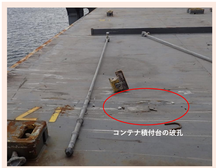
写真1 コンテナ積付台の損傷
