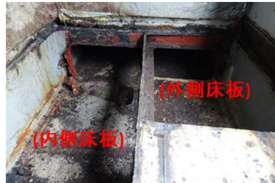
写真7 本件床板を取り外した状態
