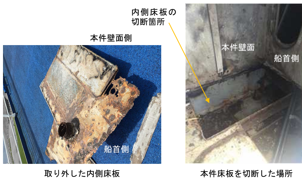
写真8 本件床板及びガス切断作業の場所
