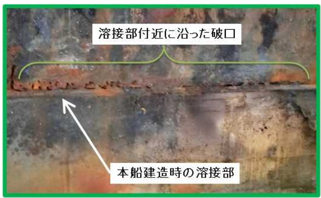
写真3 本件床板溶接部付近の破口
