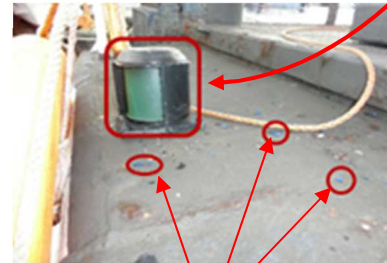
(2)右舷灯の破損
