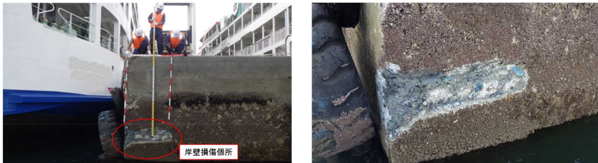
図5 本件岸壁の損傷状況
