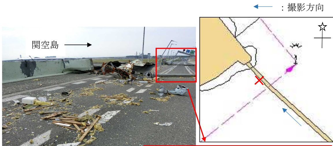
船橋付近が衝突した箇所 (P 2 付近)
