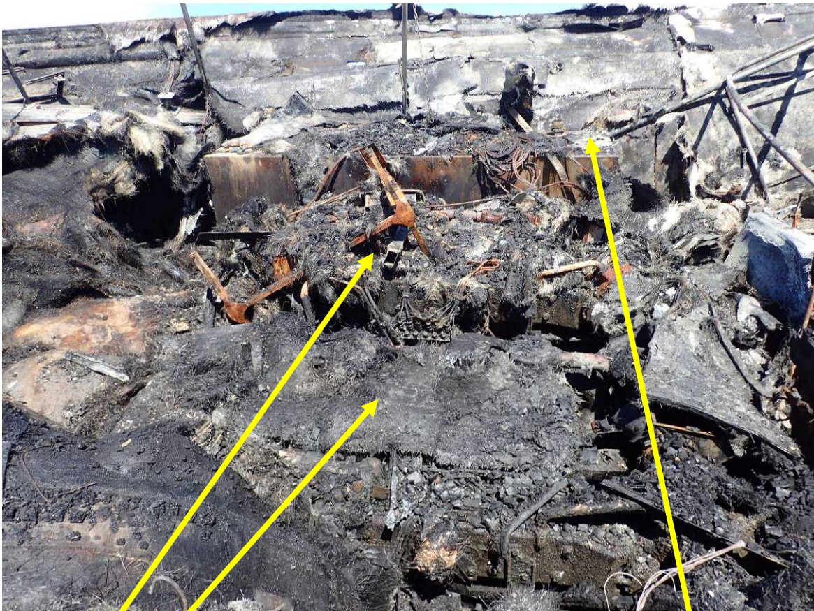
写真5 主機及び燃料タンクの状況
