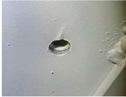
図6 椅子の取付ボルトが抜けた状態（甲板裏面）
