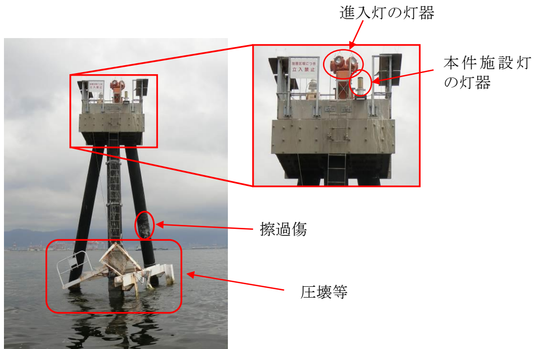
図7 本件進入灯台の損傷状況
