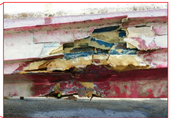
写真2.3-2 損傷状況 (拡大)
