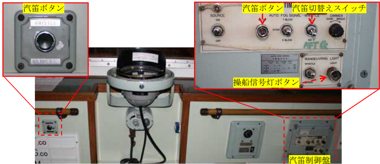
写真2.5-3 汽笛ボタン及び操船信号灯ボタン
