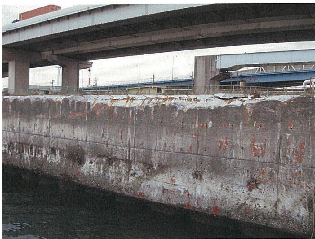
写真4 本件護岸の損傷
