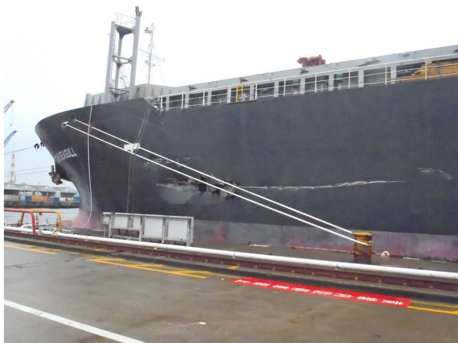
写真4 A船の損傷状況(前部その1)
