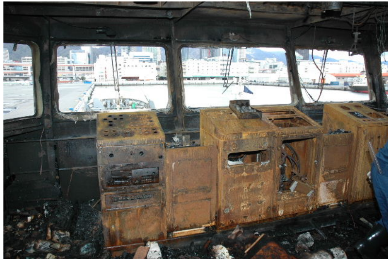
写真2 操舵室の焼損状況
