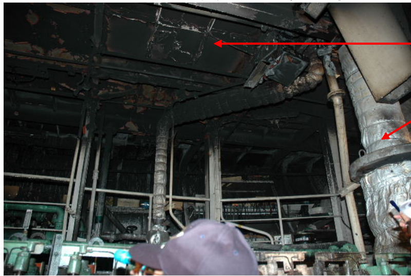
写真1 機関室の焼損状況
