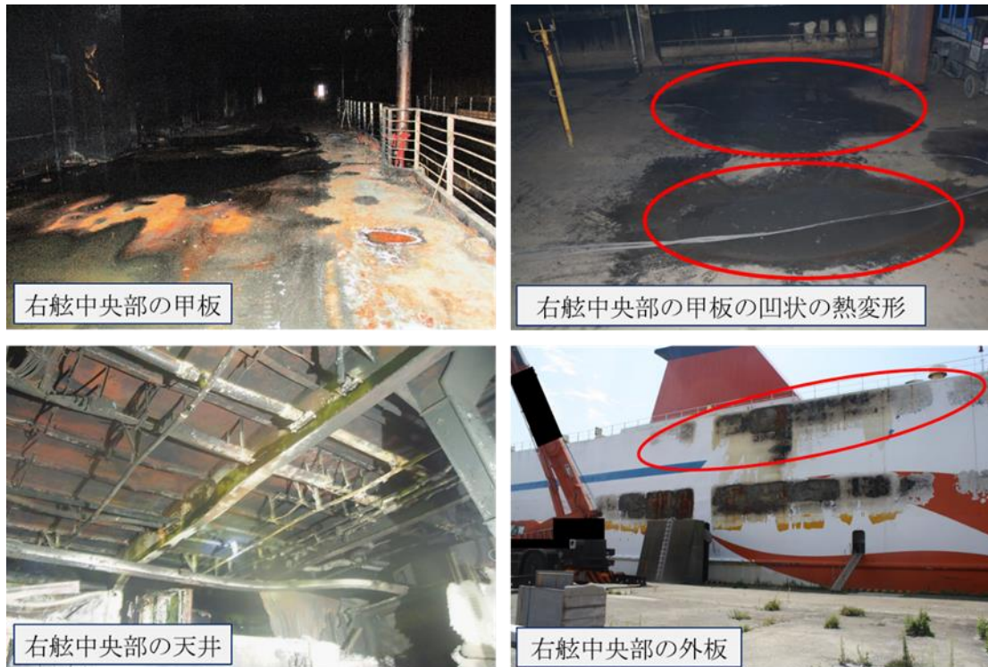
第3甲板右舷中央部の損傷状況
