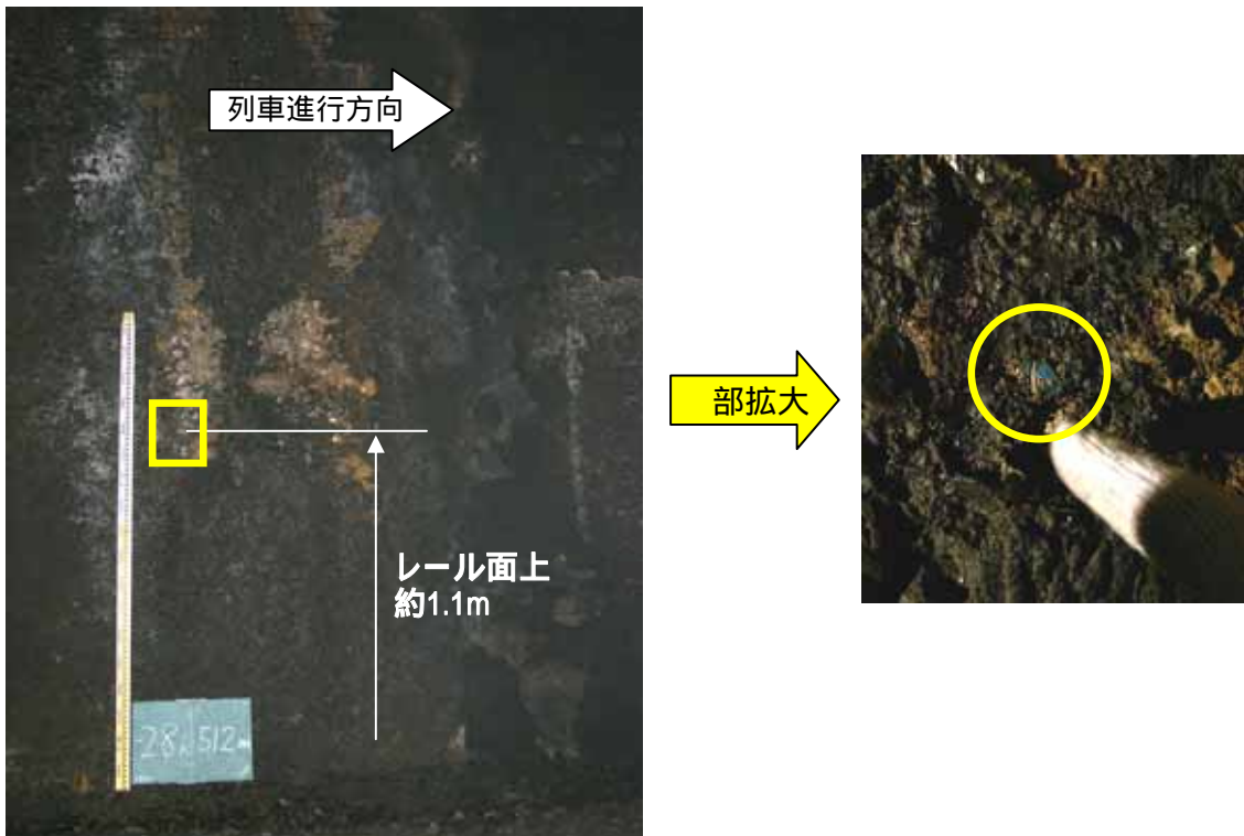
トンネル内の左側壁面に付着していた欠片 ( 2 8 k 5 1 2 m 付近 )
