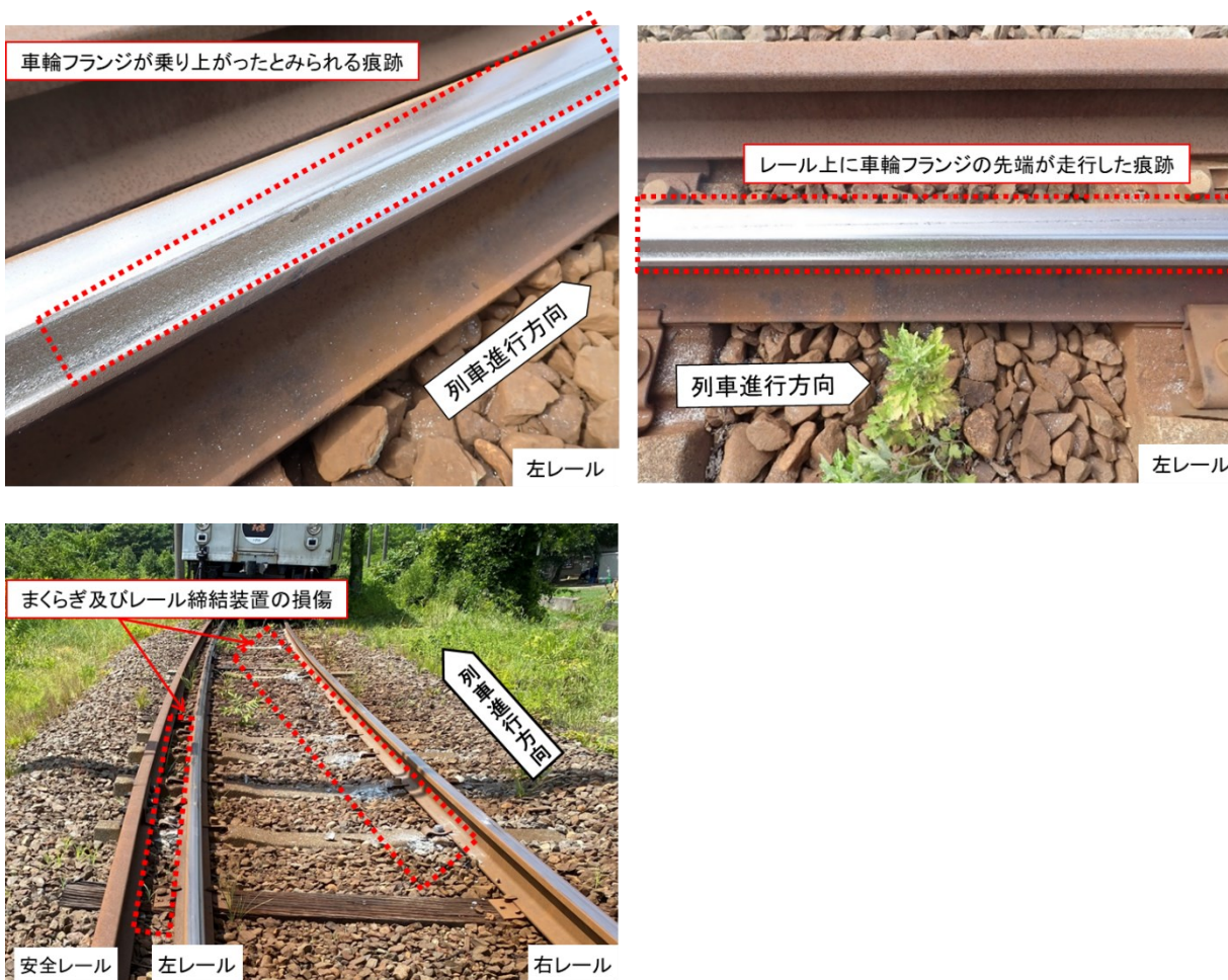
図2 鉄道施設の損傷
