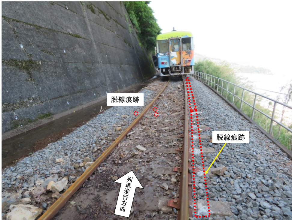
付図 1 6 脱線の痕跡 その 2
