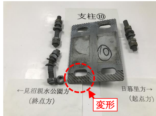
(b) 孔縁端部の変形 (支柱⑩)
