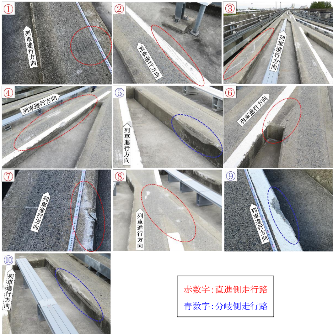
(b) 事故現場付近の走行路の損傷（各部拡大）
