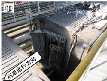
車体妻部損傷
