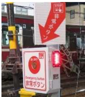
図4 本件踏切の操作装置（押しボタン）
