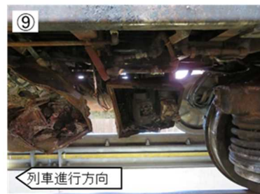
⑨ 床下機器類損傷
