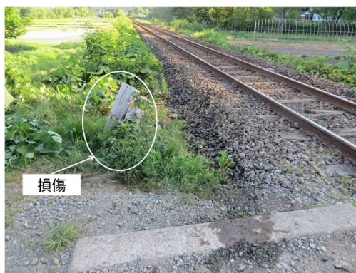
図7 杭の損傷状況
