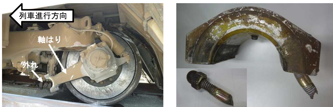
図6 軸箱支持装置の損傷状態（左：事故直後の状態、右：押さえ金と折損したボルト）
