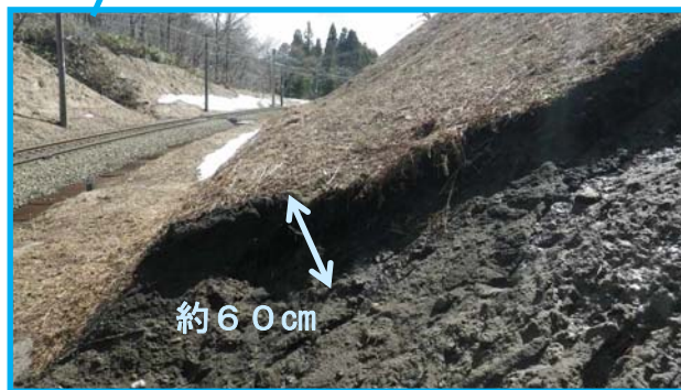
崩壊した斜面の深さ
