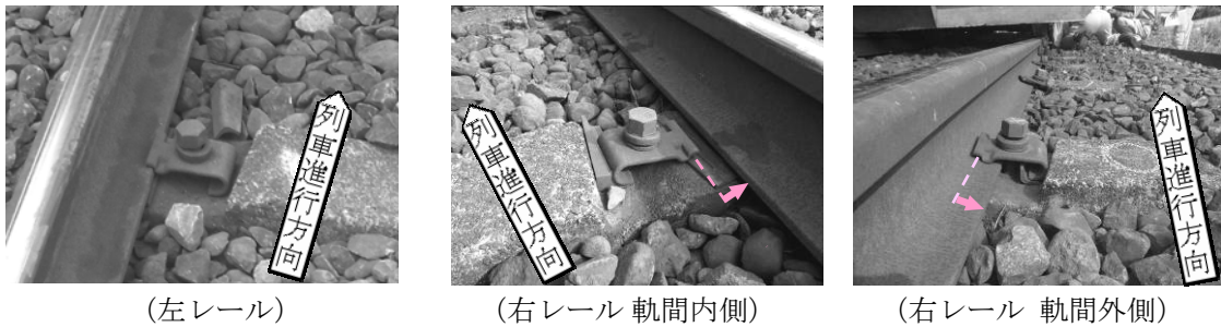
写真1 2k214m付近のレールとその締結の状態
