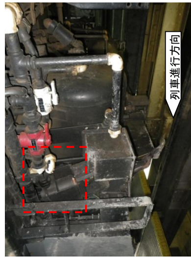
ちりこしの曲損及び配管の破断
