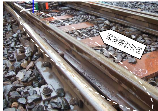
左トングレール左側面の擦過痕
