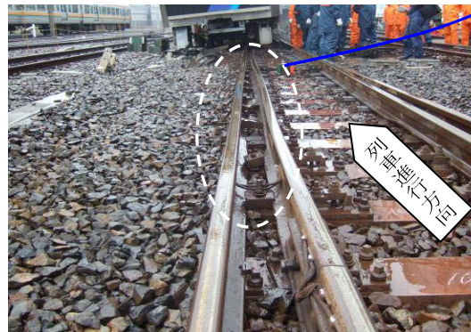
左基本レールと左トングレールの間の脱線痕及び右に湾曲した左トングレール
