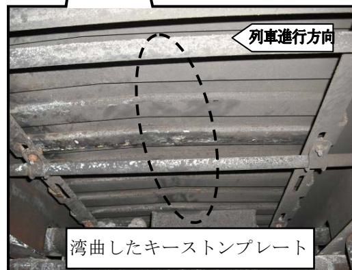
床下の焼損状況
