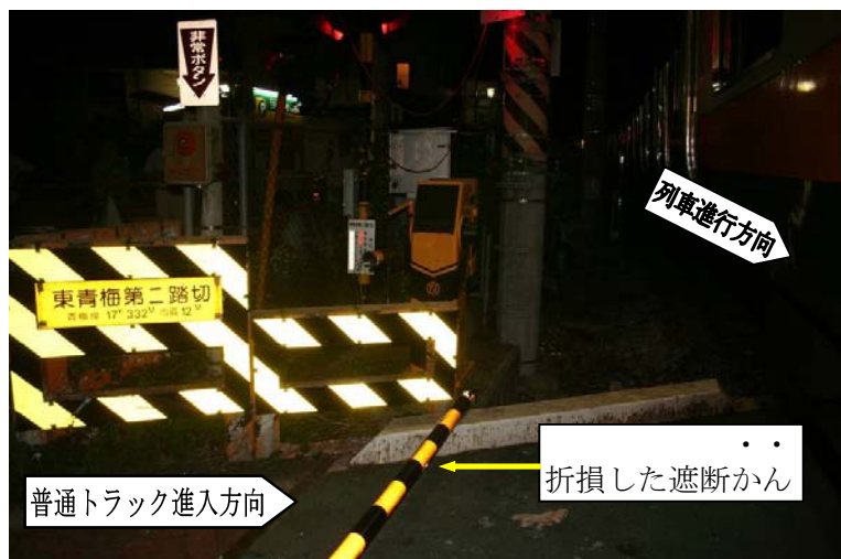
写真5 鉄道施設の損傷及び痕跡の状況
