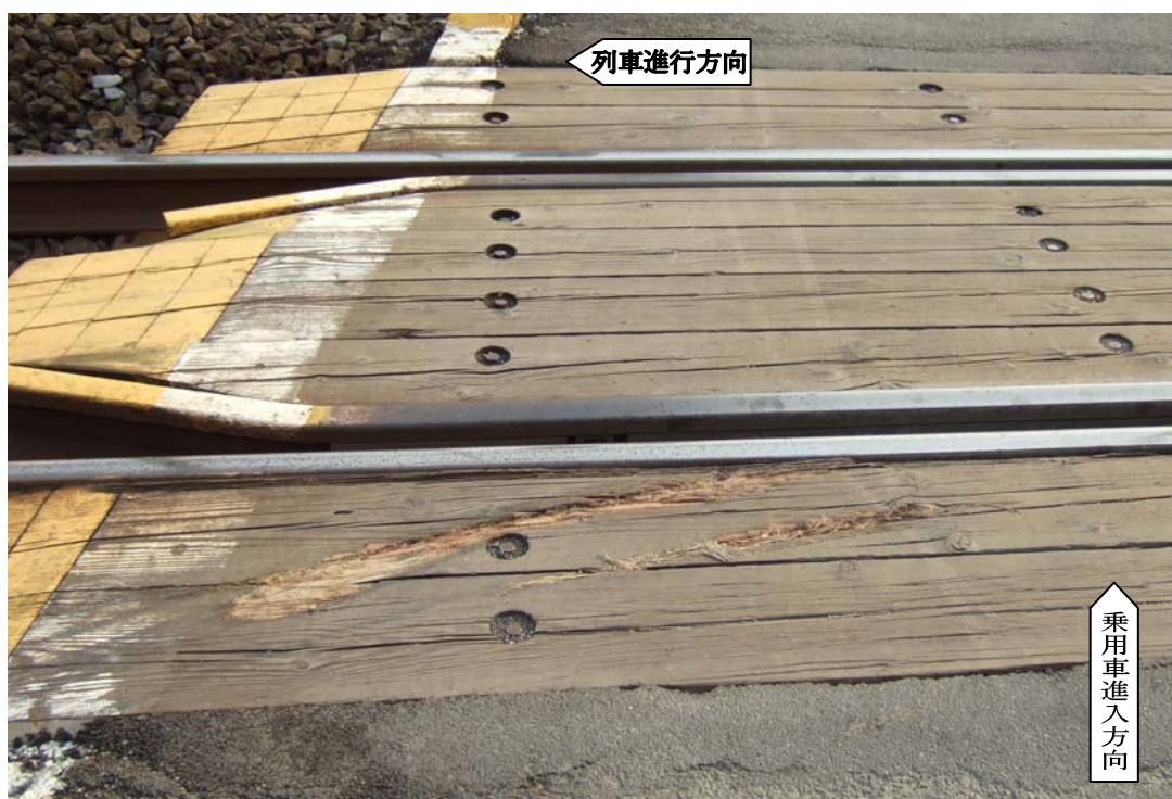
踏切敷板 (木製) の損傷状況
