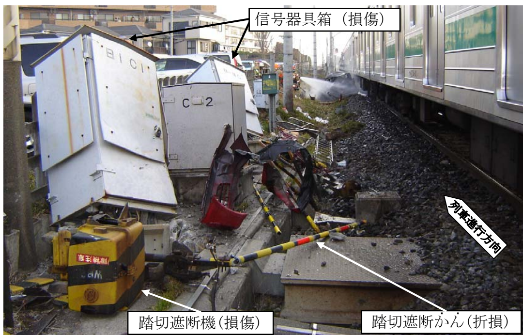
踏切遮断機等の損傷状況
