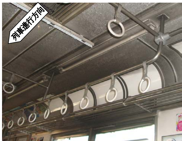
客室天井の焼損状況
