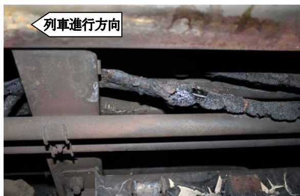
床下の焼損状況
