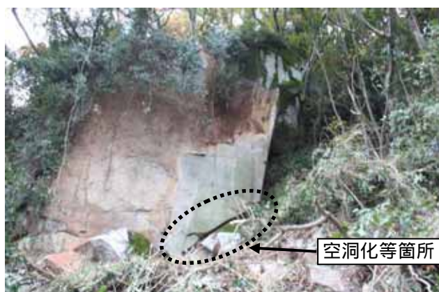
写真6 本件崩壊箇所
