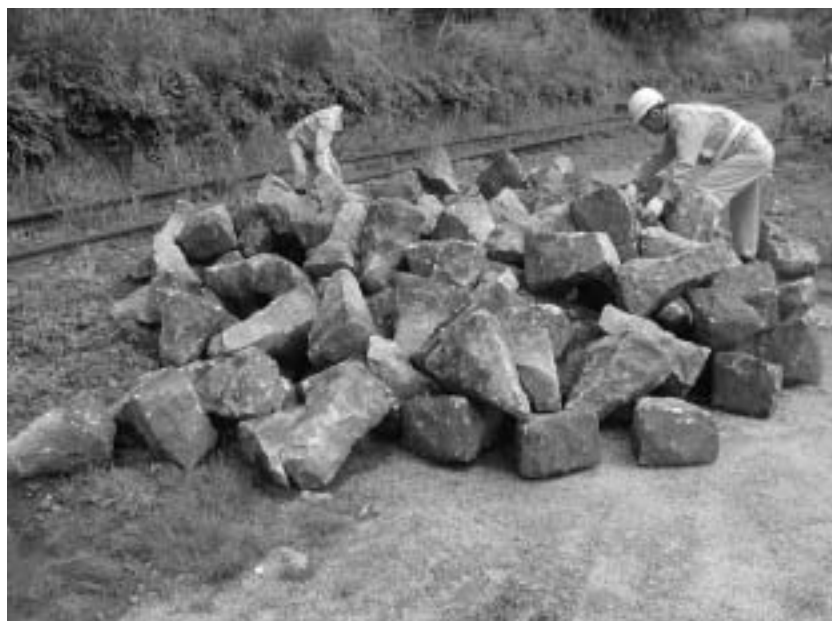
写真5 崩落した間知石の集積状況
