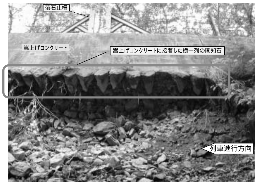
写真4 落石止擁壁崩壊の状況(2)
