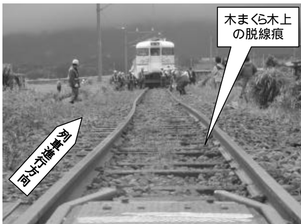
写真3 脱線現場の状況(3)
