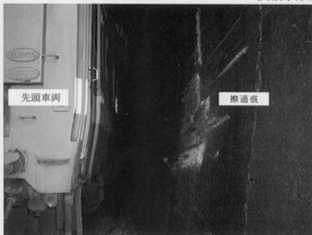
写真8 トンネル右側側壁コンクリートの損傷状況
