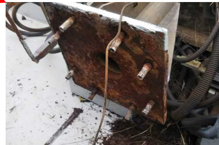
本件信号機柱の台座裏面の状況
