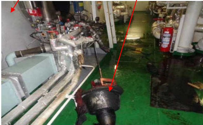
Photo 2.3-1 Burner unit door
