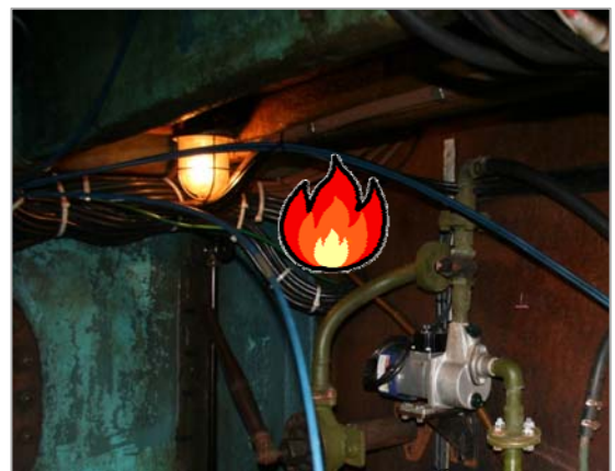
機関室隔壁電線貫通部
