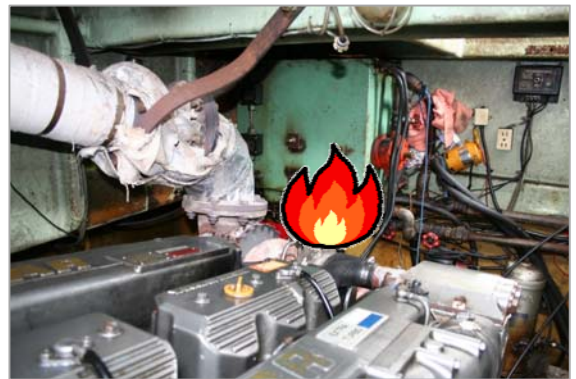
主機過給機付近
