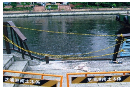
転落防止柵の損傷状況
