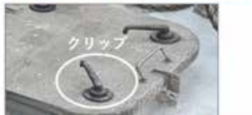
ハッチ蓋が2cm程度浮いた状態
