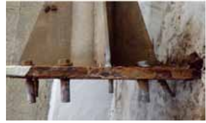
信号機倒壊（新札幌駅構内）
