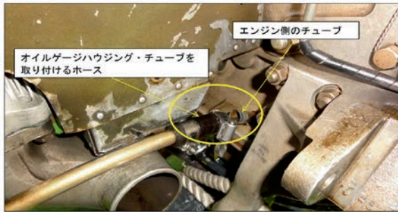
ホースがエンジン側チューブから外れた部分の再現
