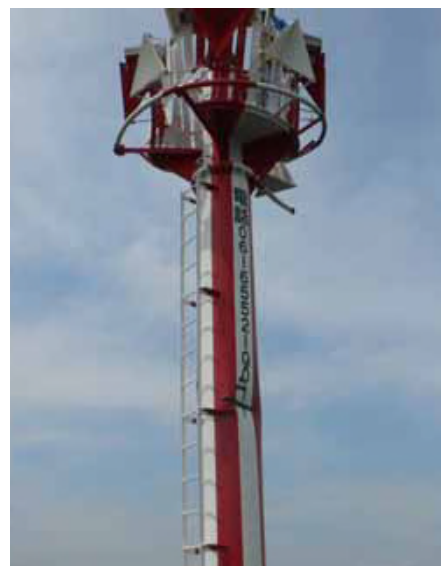
損傷した大阪灯標 (凹損及び亀裂)
