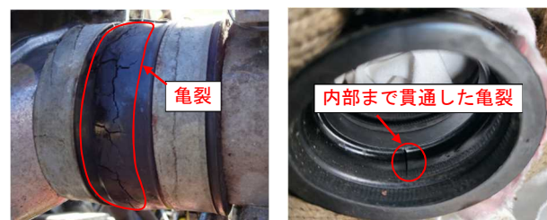
図4 ラバーソケットの劣化状況
