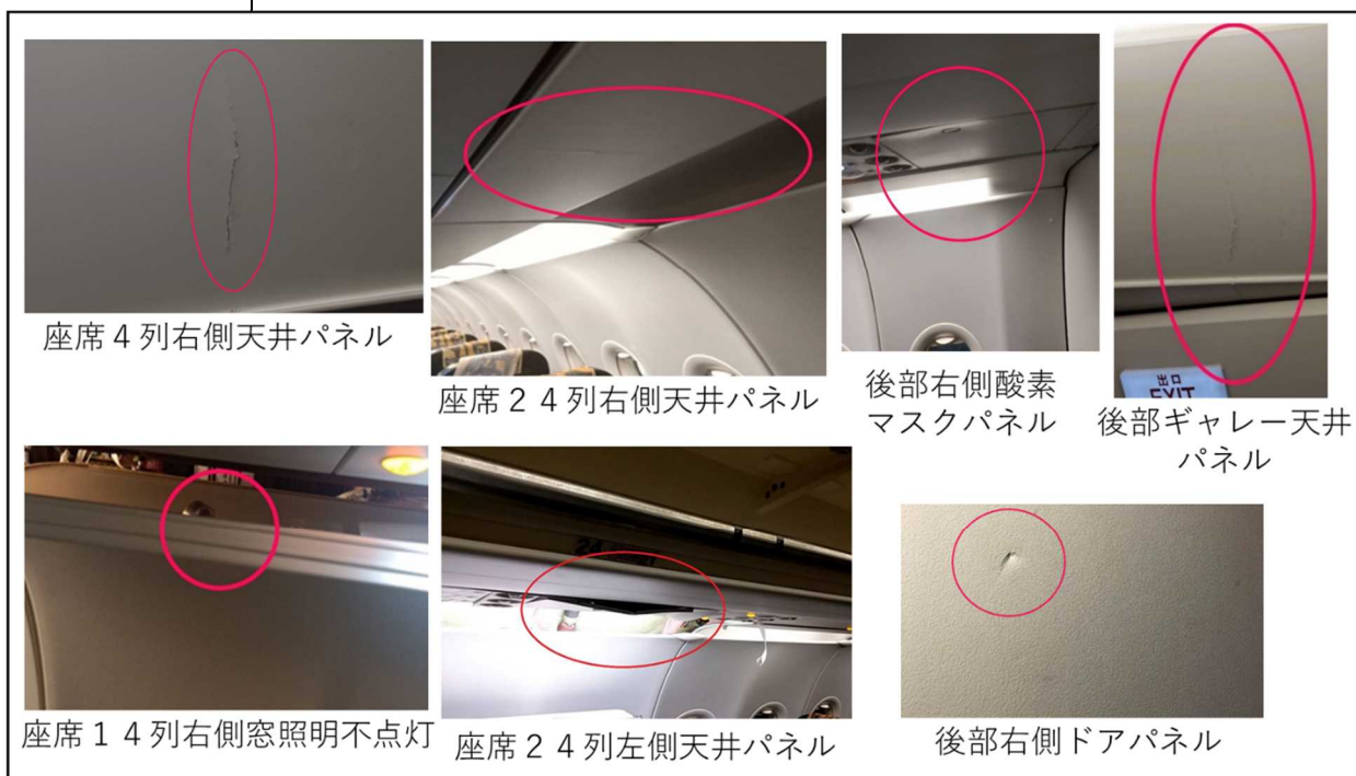
図2 客室内部損傷箇所
