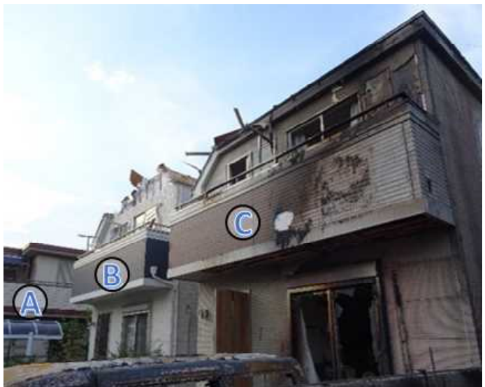
写真2.4.2-4 住宅Cの焼損状況
