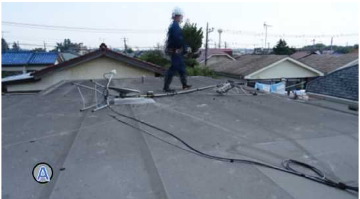
写真2.4.2-2 住宅Aの倒壊したテレビアンテナ
