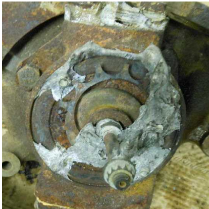
写真# 1 9 圧縮機の残骸 (左側)
