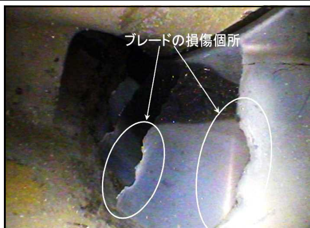
(写真6 No.1エンジン軸流式コンプレッサー1段目)
