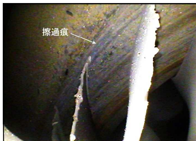
(写真7 No.1エンジン遠心式コンプレッサー)
