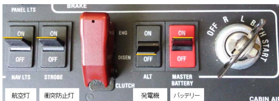
同機のスイッチパネルの一部
