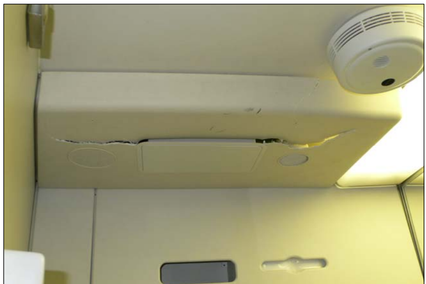
化粧室天井部の 亀裂破損
