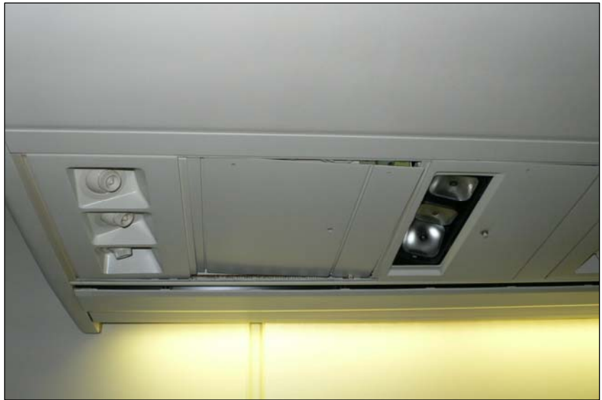
客室天井部の パネルの損傷
